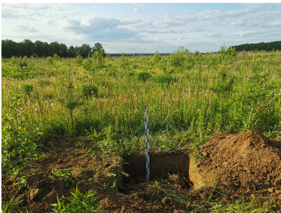
Рис. 32. Объект: «Отвод "Калужский". Средства ЭХЗ ЛЧ DN 250 с организацией электроснабжения. Реконструкция». Участок СКЗ №14, Калужская область, Ферзиковский район, д. Перцево, Рязанское РНУ. Ждамирово, поселение 4. Общий вид с Ю на шурф 50.
