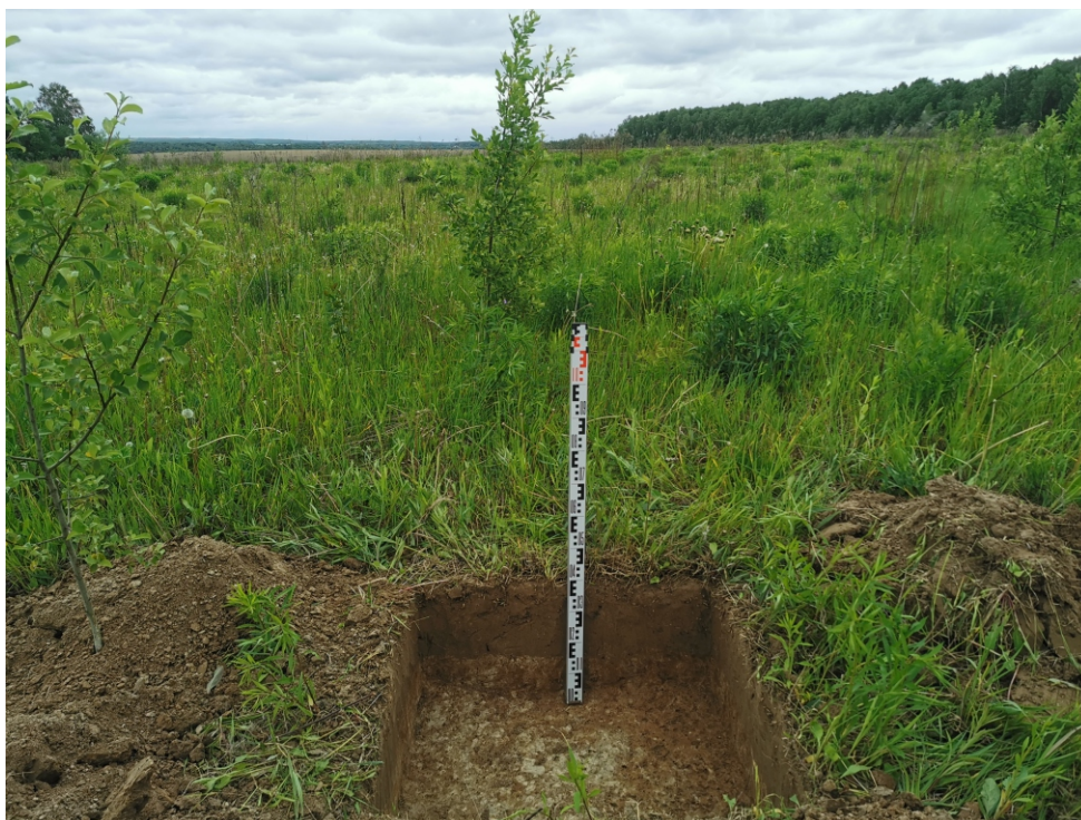
Рис. 45. Объект: «Отвод "Калужский". Средства ЭХЗ ЛЧ DN 250 с организацией электроснабжения. Реконструкция». Участок СКЗ №14, Калужская область, Ферзиковский район, д. Перцево, Рязанское РНУ. Ждамирово, поселение 4. Общий вид с Ю на шурф 53.
