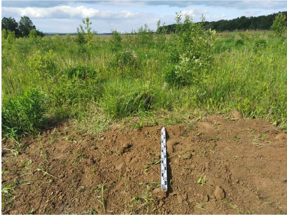
Рис. 73. Объект: «Отвод "Калужский". Средства ЭХЗ ЛЧ DN 250 с организацией электроснабжения. Реконструкция». Участок СКЗ №14, Калужская область, Ферзиковский район, д. Перцево, Рязанское РНУ. Ждамирово, поселение 4. Вид с Ю на рекультивацию шурфа 58.
