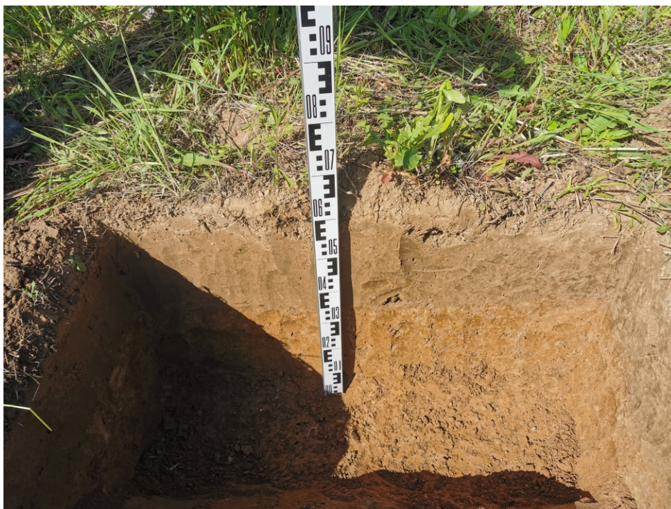
Рис. 71. Объект: «Отвод "Калужский". Средства ЭХЗ ЛЧ DN 250 с организацией электроснабжения. Реконструкция». Участок СКЗ №14, Калужская область, Ферзиковский район, д. Перцево, Рязанское РНУ. Ждамирово, поселение 4. Вид с Ю на прокопку материка в шурфе 58.
