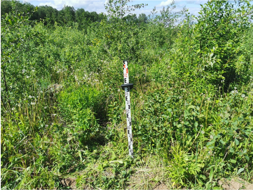
Рис. 59. Объект: «Отвод "Калужский". Средства ЭХЗ ЛЧ DN 250 с организацией электроснабжения. Реконструкция». Участок СКЗ №14, Калужская область, Ферзиковский район, д. Перцево, Рязанское РНУ. Ждамирово, поселение 4. Вид с Ю на разбивку шурфа 57.
