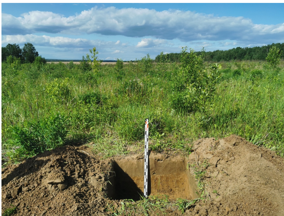
Рис. 72. Объект: «Отвод "Калужский". Средства ЭХЗ ЛЧ DN 250 с организацией электроснабжения. Реконструкция». Участок СКЗ №14, Калужская область, Ферзиковский район, д. Перцево, Рязанское РНУ. Ждамирово, поселение 4. Общий вид с Ю на шурф 58.
